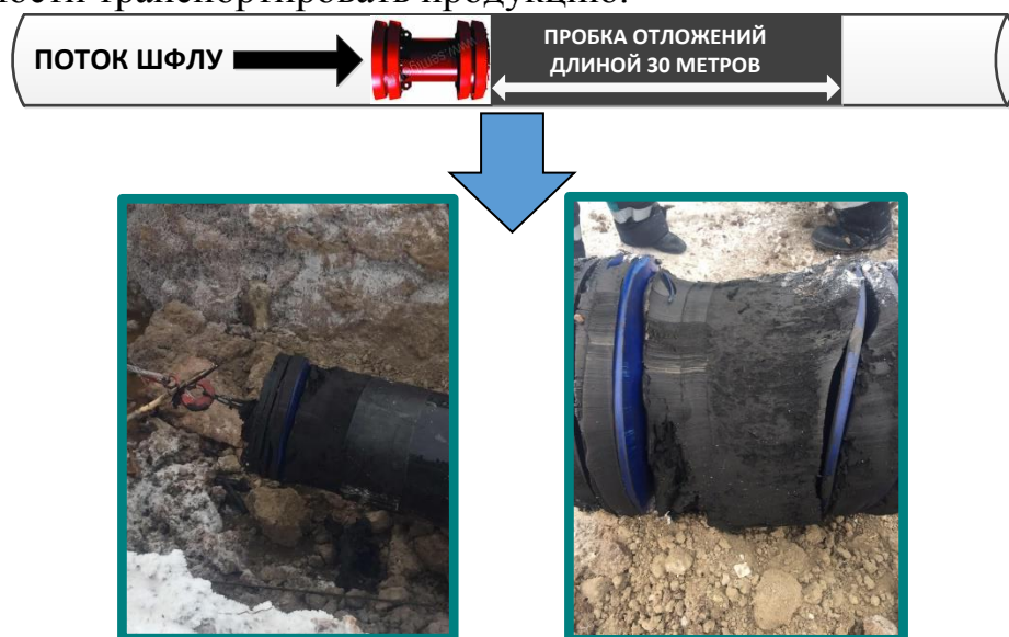
Рисунок 1. Отложения во внутренней полости магистрального продуктопровода ШФЛУ
