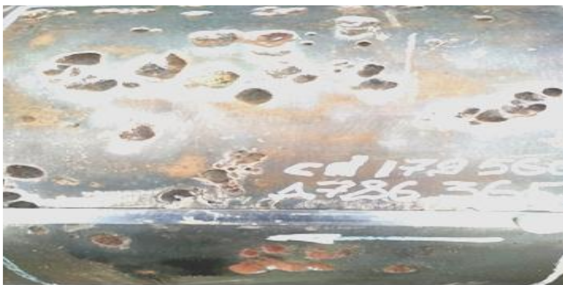
Рис.2. Коррозионные дефекты магистральных трубопроводов
