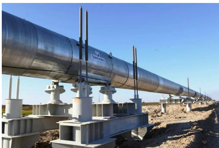
Рис. 2– Надземная часть нефтепровода «Заполярье - Пурпе» с установленными термостабилизаторами.
