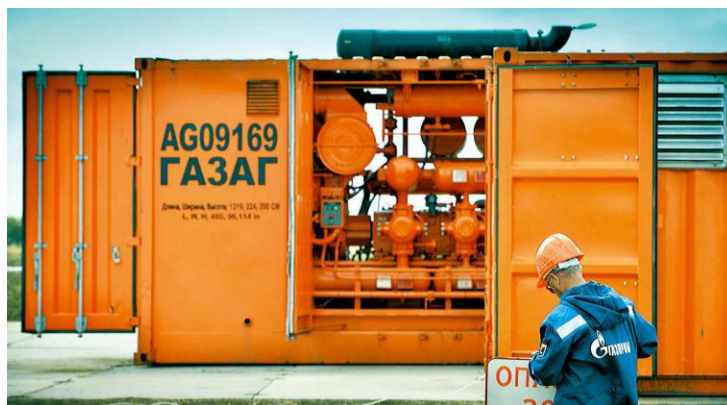
Рис. 1 Мобильная компрессорная станция
