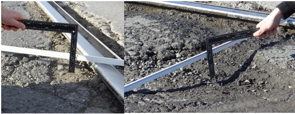
Рисунок 2. Состояние дорожного покрытия на железнодорожном переезде ТКАД (на участке между ул. Фирменная и ул. Буковая в октябре 2018 года (слева) и в марте 2019 года (справа) по правой полосе наката.
