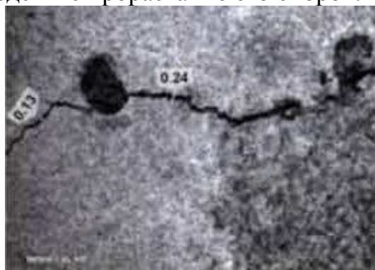
Рисунок 1. Состояние на момент образования трещины
