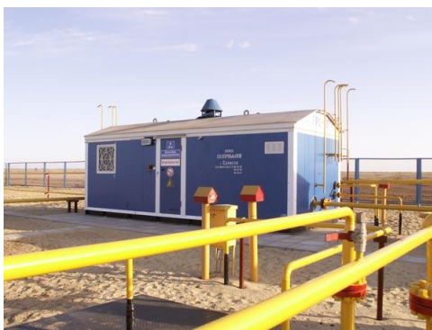
Рис. 1. Автоматизированная газораспределительная станция
