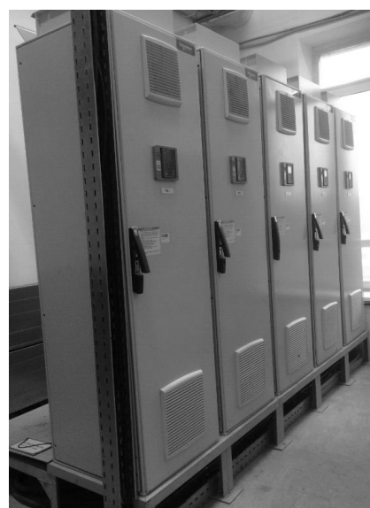
Рис.2. Преобразователи частоты на насосной станции водотока
