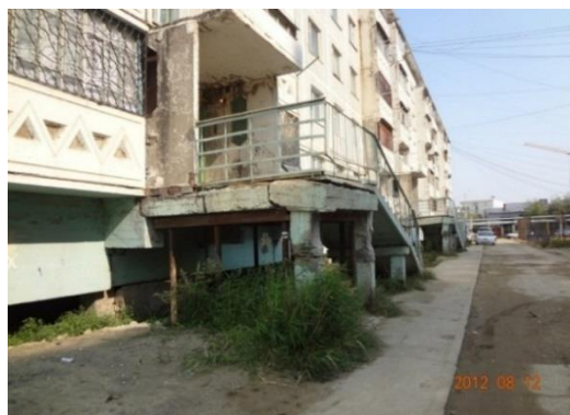
Рис. 1. Выпучивание малонагруженных свай крыльца (г. Якутск)
