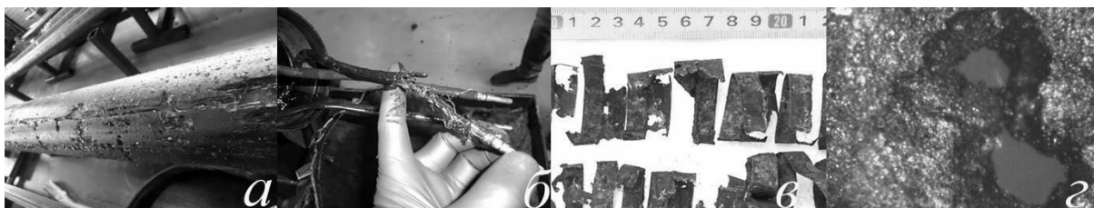
Рисунок 2. а – коррозия корпуса ПЭД по всей длине; б – оплавленная изоляция токопроводящей жилы кабеля; в – фрагменты брони кабеля; г – характерный участок стальной основы брони кабеля после разрушения в результате электрокоррозии
