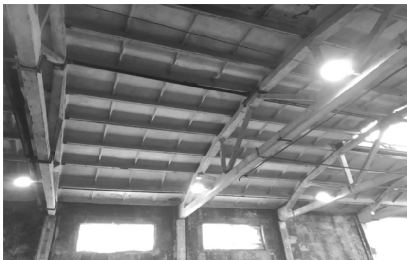
Рис. 1 – Общий вид стропильных ферм
