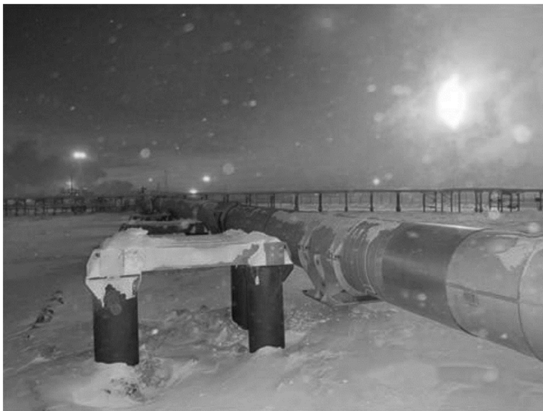
Рисунок 1. Сход промышленного трубопровода с опорных поверхностей
