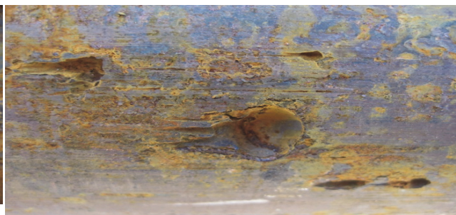
Коррозия в виде одиночных язв круглой формы
