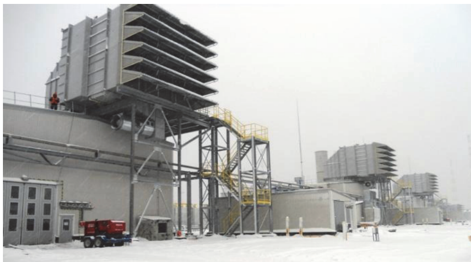
Рисунок 1 – Импульсное КВОУ с самоочищающимися фильтрами ASC компании ААФ для газовой турбины Trent60 мощностью 50 МВт компании Rolls Royce. Компрессорная станция «Портовая» магистрального газопровода «Северный Поток».
