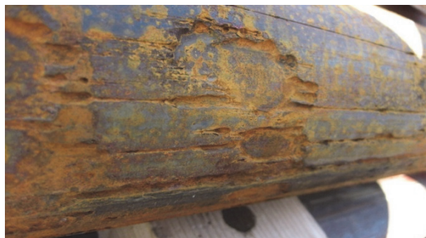
Локальная коррозия в виде узких параллельных бороздок и овальных плато
