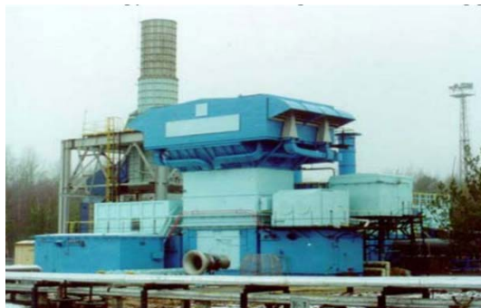
Рисунок 1. Газоперекачивающий агрегат ГПА-16 «Нева»
