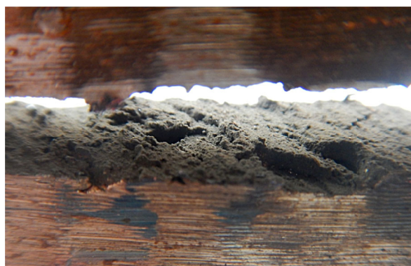
Рисунок 3 – Вид повреждения фланца
