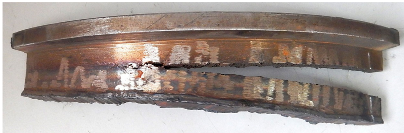
Рисунок 1 – Общий вид повреждения фланца
