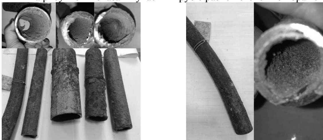
Рисунок 1 - Поражение стенки металла коррозией
