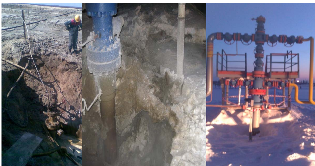
Рисунок 1. Деформации устьев скважин
