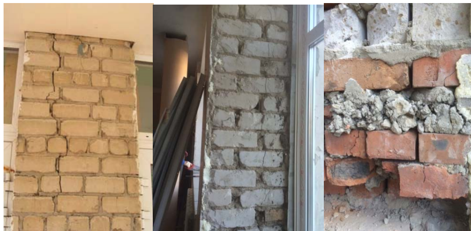
Рисунок 1. Фотофиксация дефектов каменной кладки
