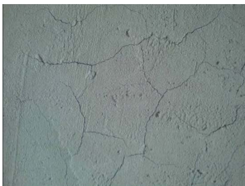
Рисунок 3. Трещины под временной нагрузкой
