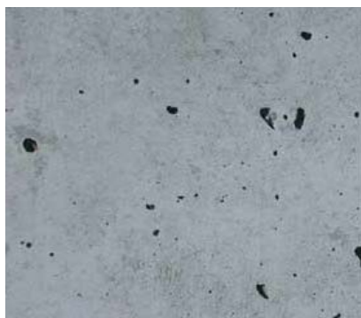
Рисунок 1. Раковины пустоты, на поверхности бетона
