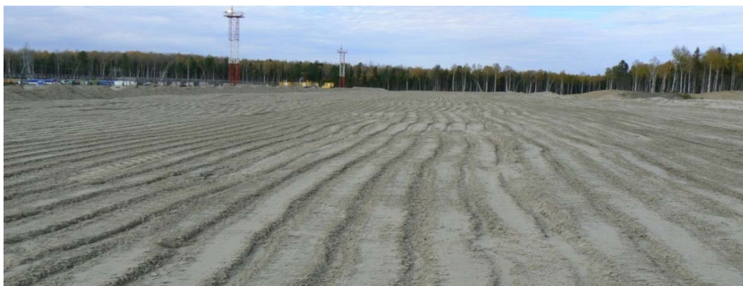
Рисунок 1 Применение технологии ТюмГАСУ и гравтобетона на основе БШ для рекультивации пыльных амбаров
