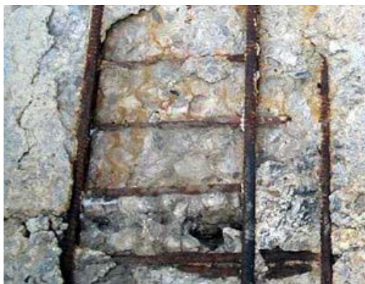
Рисунок 1. Коррозия стальной арматуры в теле бетона
