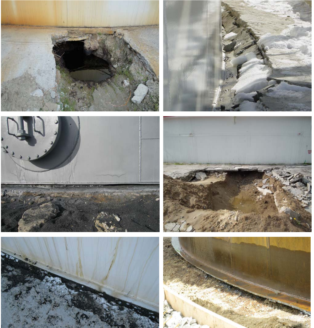
Рисунок 1.2 - Повреждения вертикальных стальных резервуаров в результате неравномерной осадки основания
