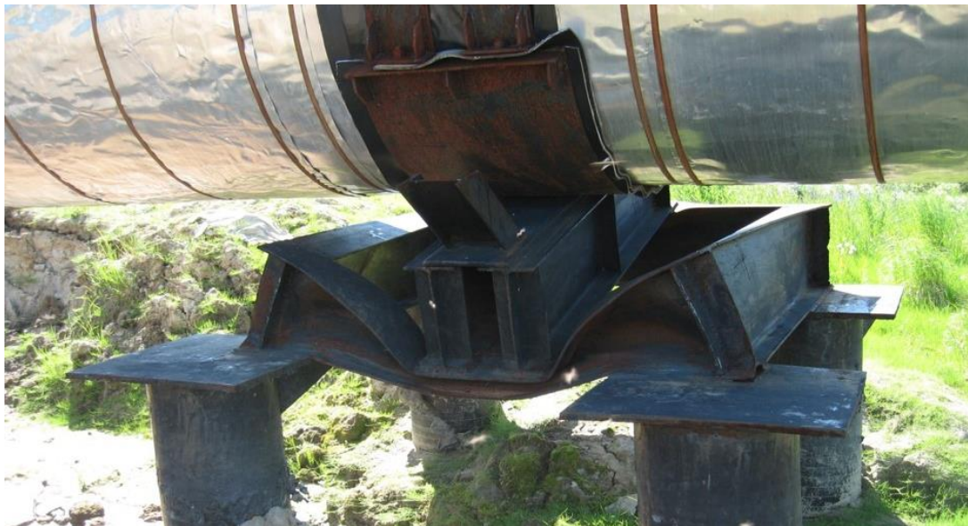
Рисунок 1.2 - Инцидент №2. Выпучивание свайных опор надземного участка магистрального газопровода диаметром 720x9 мм, сопровождающееся разрушением скользящей опоры
