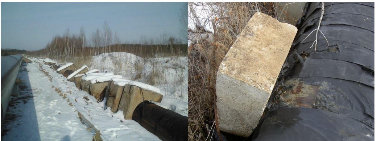
Рисунок 1.1 - Инцидент №1. Смещение утяжелителей морозным пучением грунтов (слева) и связанное с этим повреждение антикоррозионного покрытия (справа) на магистральном газопроводе диаметром 1020x16 мм
