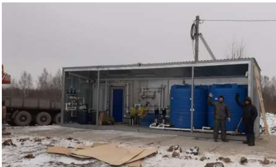
Рисунок 1. Размещение блочной станции водоочистки на площадке
