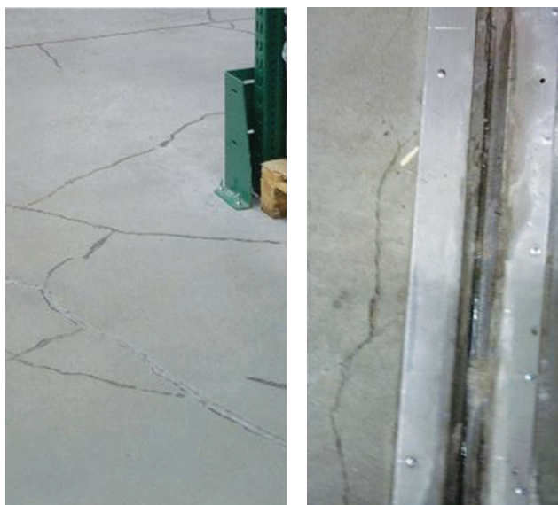
Рис. 1. Усадочные и деформационные трещины
