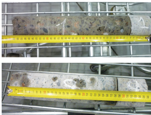
Рис. 3. Отобранные для исследования керны железобетонного основания № 1 и № 9
