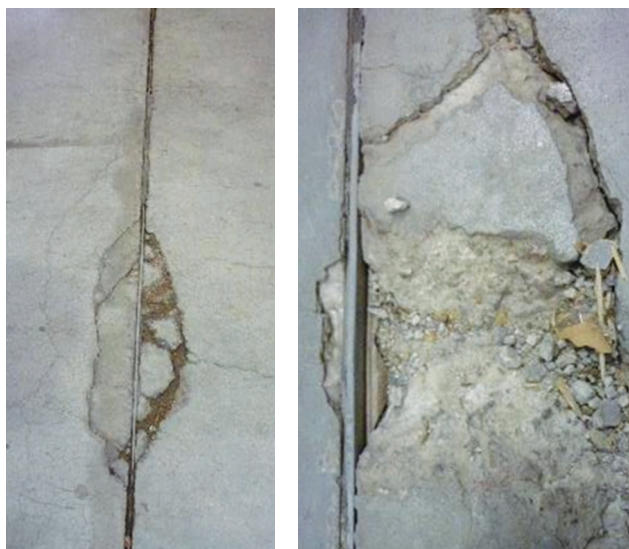
Рис. 2. Отслоение и разрушение упрочненного покрытия
