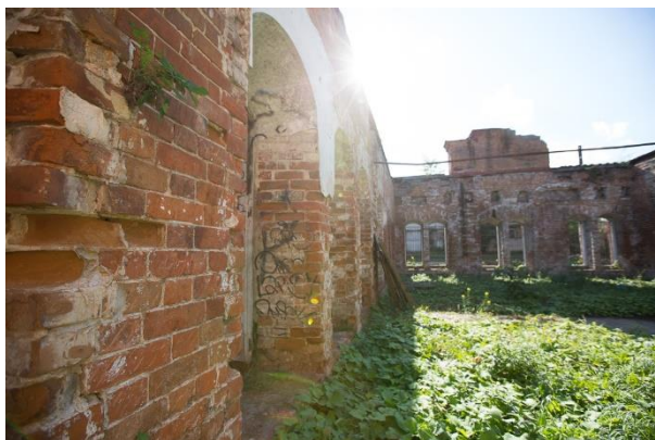
Рисунок 1.3. – Фото руинированного здания электростанции (2010-е гг.)
