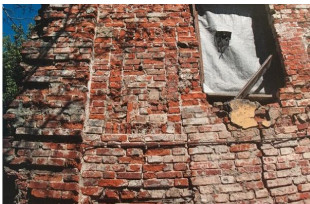
Рисунок 3.1. – Фрагмент руинированной кирпичной кладки стены флигеля до реставрации
