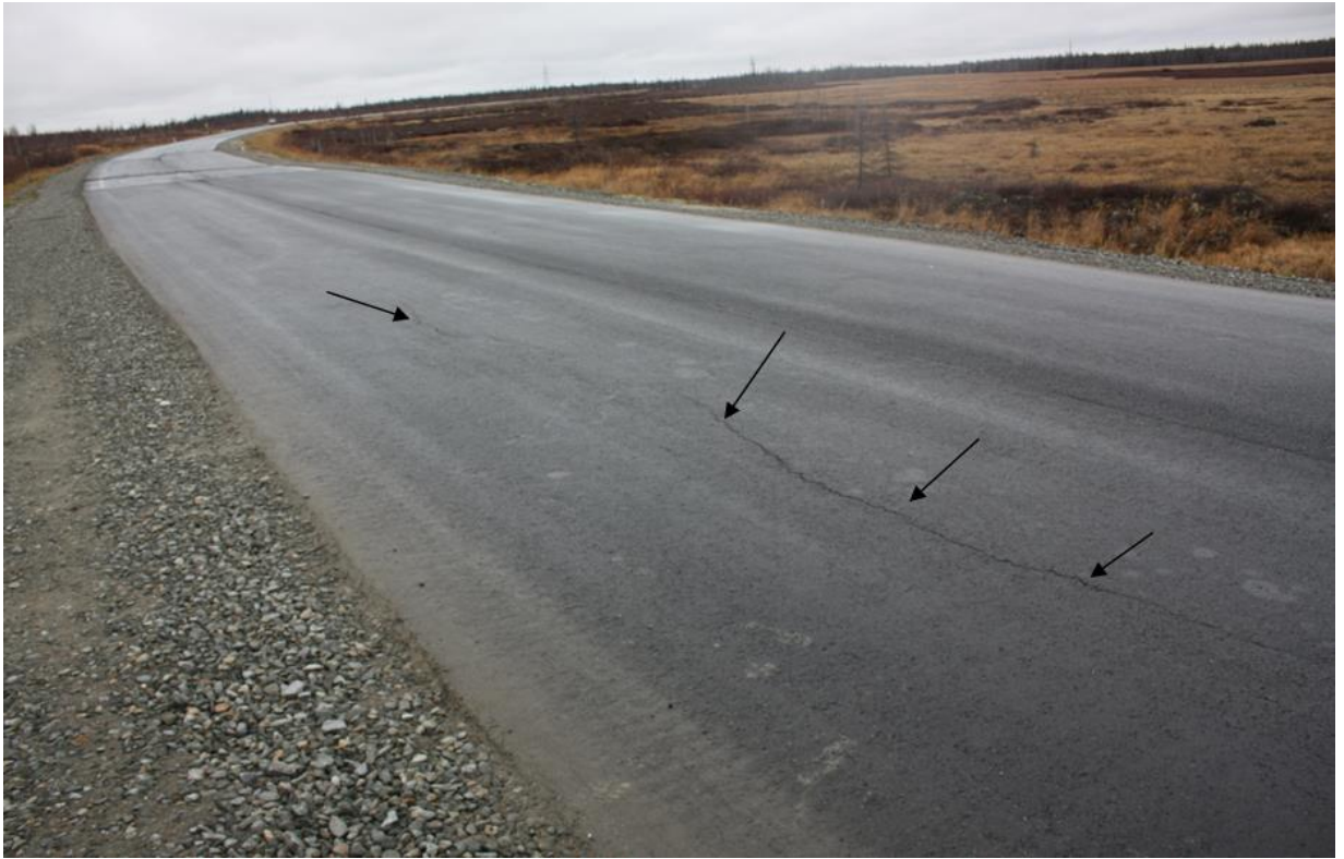
Рисунок 2.5 – Развитие продольных трещин на ПК 564+68 после ремонтно-восстановительных работ
