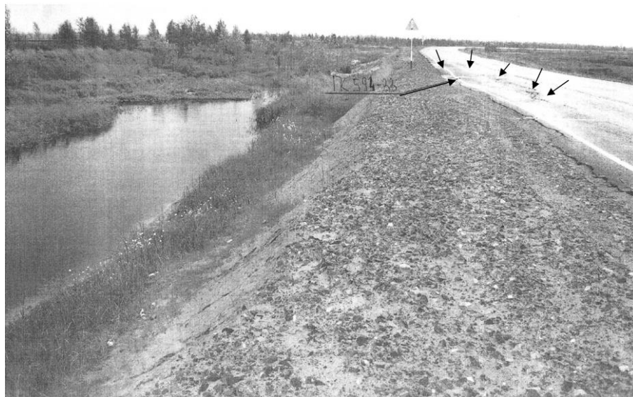
Рисунок 2.8 – Разрушенный участок дороги (ПК 594+30). Просадка покрытия, кромки и части обочины
