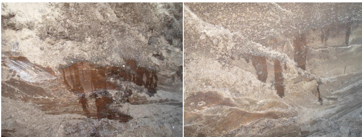
Рисунок 2.15 – Фильтрация воды через слой уплотненного торфа на границе ЗП-основание (февраль-март 2013 г.)
