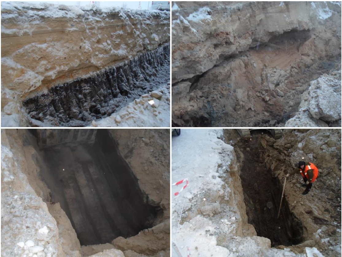
Рисунок 2.16 – Толща талого торфа в основании автомобильной дороги (февраль-март 2013 г.)
