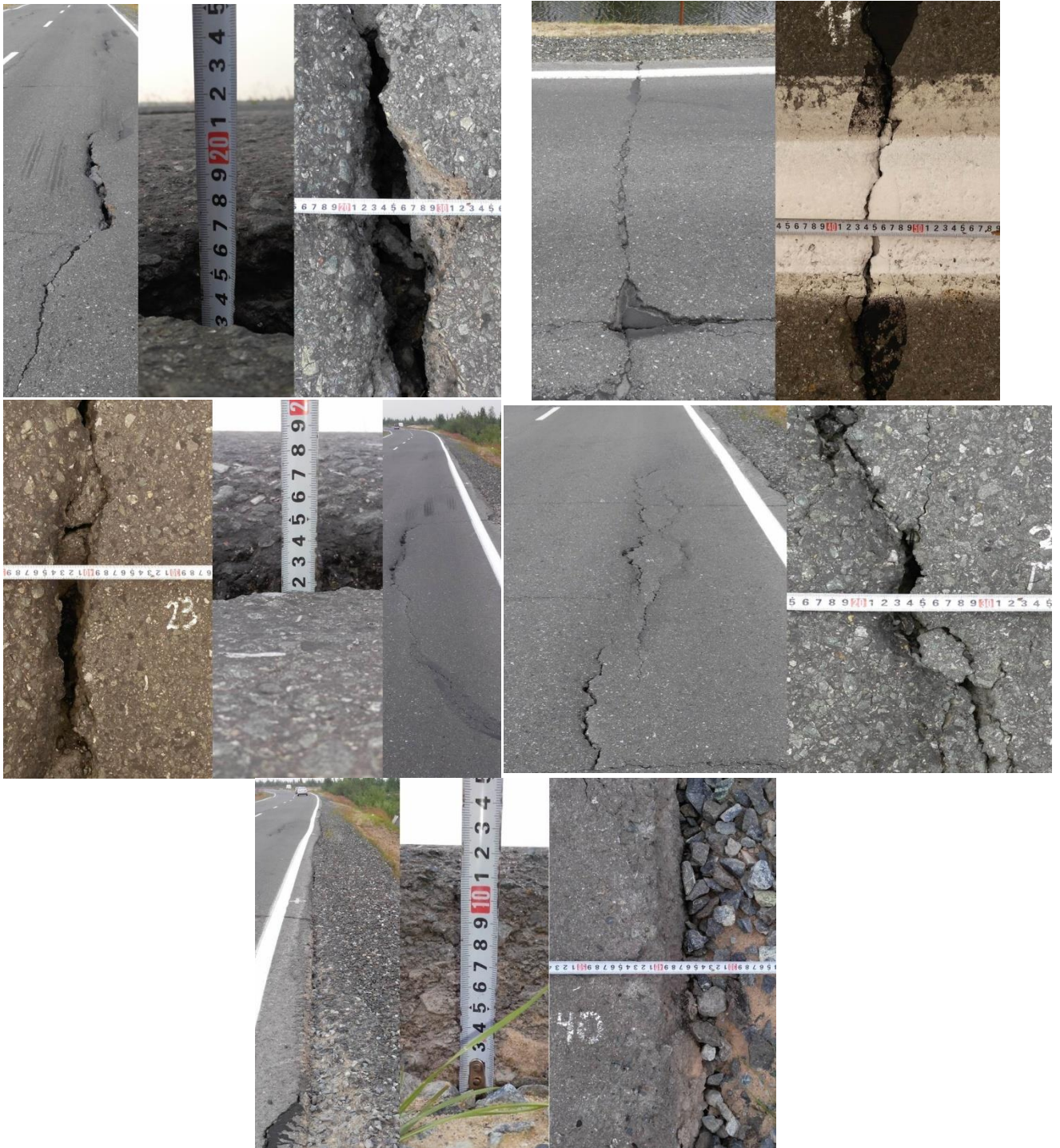
Рисунок 2.26 – Фотофиксация деформаций на рассматриваемом участке (июнь 2016 г.)
