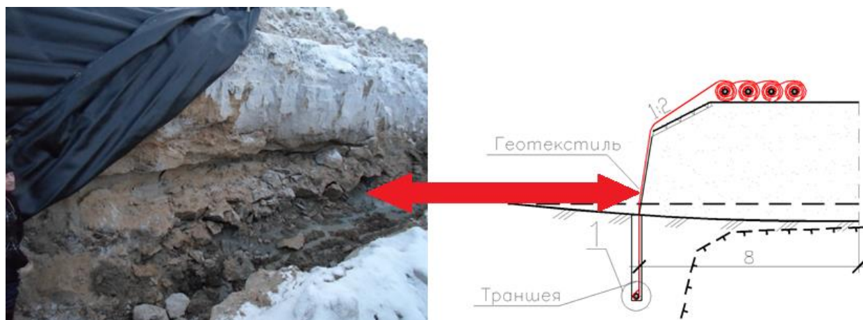
Рисунок 3.1 – Фильтрация воды через конструкцию ЗП (12 марта 2013 г.)
